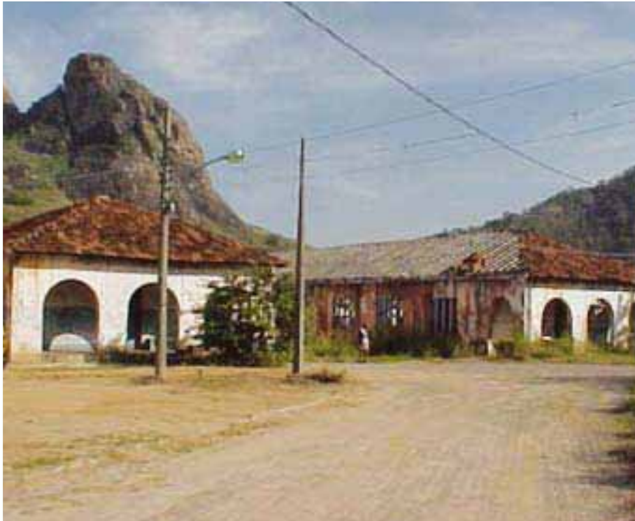
31 - NFR - Pavilhões em ruínas.
