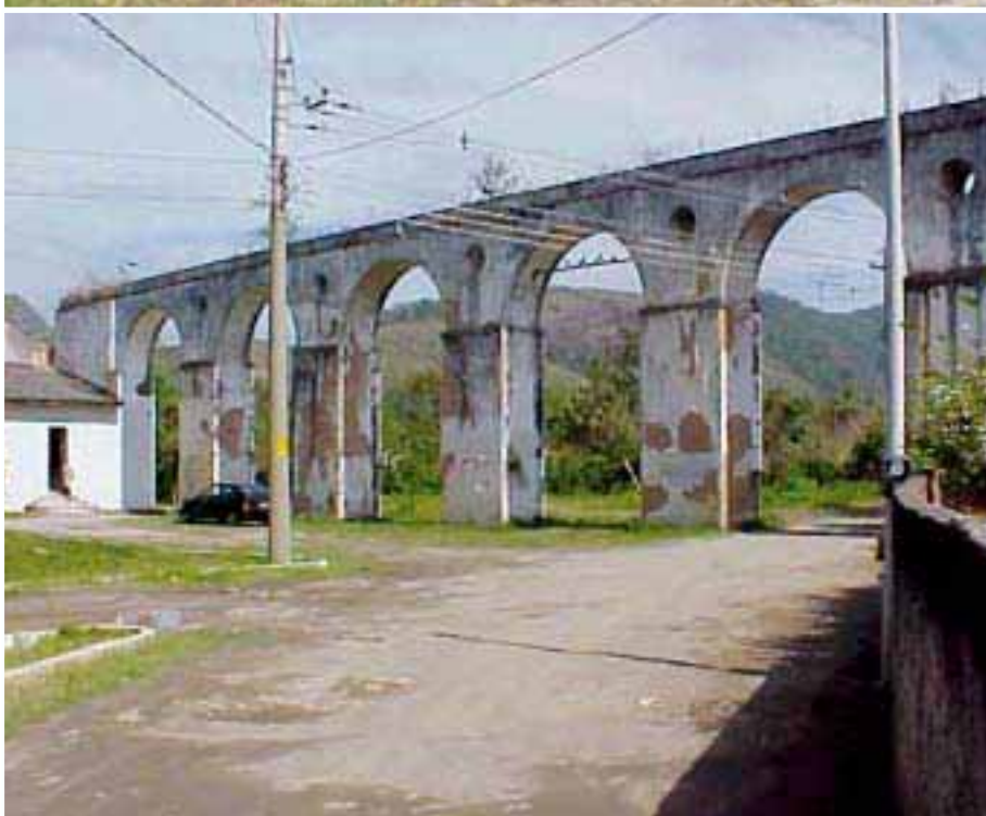
74 - NRC - Aqueduto. Está situado no núcleo original da fazenda, em frente à Igreja e à antiga Casa da Fazenda. Foi construído na metade do séc. XVIII, servindo de condutor das águas das nascentes, para o funcionamento do moinho de fubá e para abastecer os engenhos de cana da região. É composto de oito arcos de plena volta sob pilares. Um dos arcos já não existe mais.
