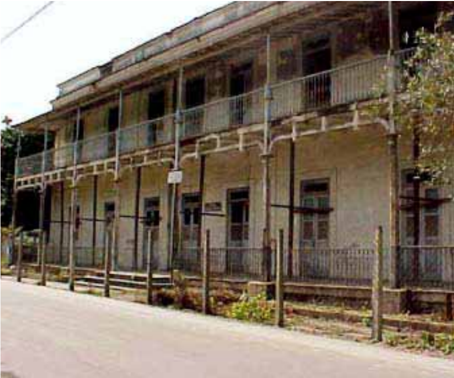
64 - NRC - Pavilhão Carolina Medrado (antiga sede da fazenda do Engenho Novo) - Desativado. Tem uma área construída de 900 m 2 e um prédio anexo que hoje se encontra ocupado por servidores. A varanda de estrutura metálica, incorporada a uma das fachadas laterais, está em precaríssimas condições de conservação. Nesse prédio funcionava o centro médico-administrativo, por sua localização central em relação aos pavilhões.
