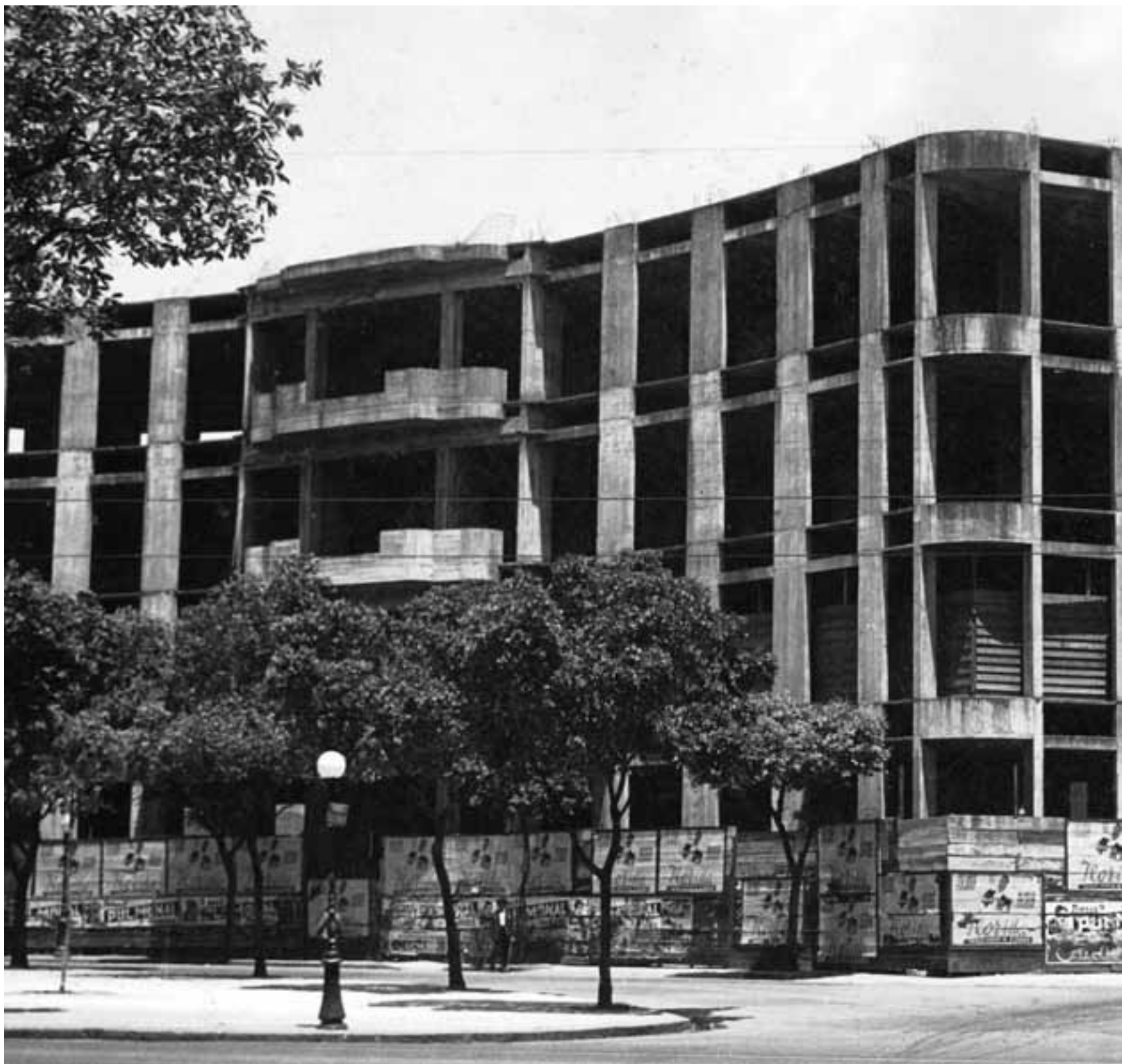
Construção do edifício que abrigaria o Instituto Nacional de Câncer, na praça Cruz Vermelha
