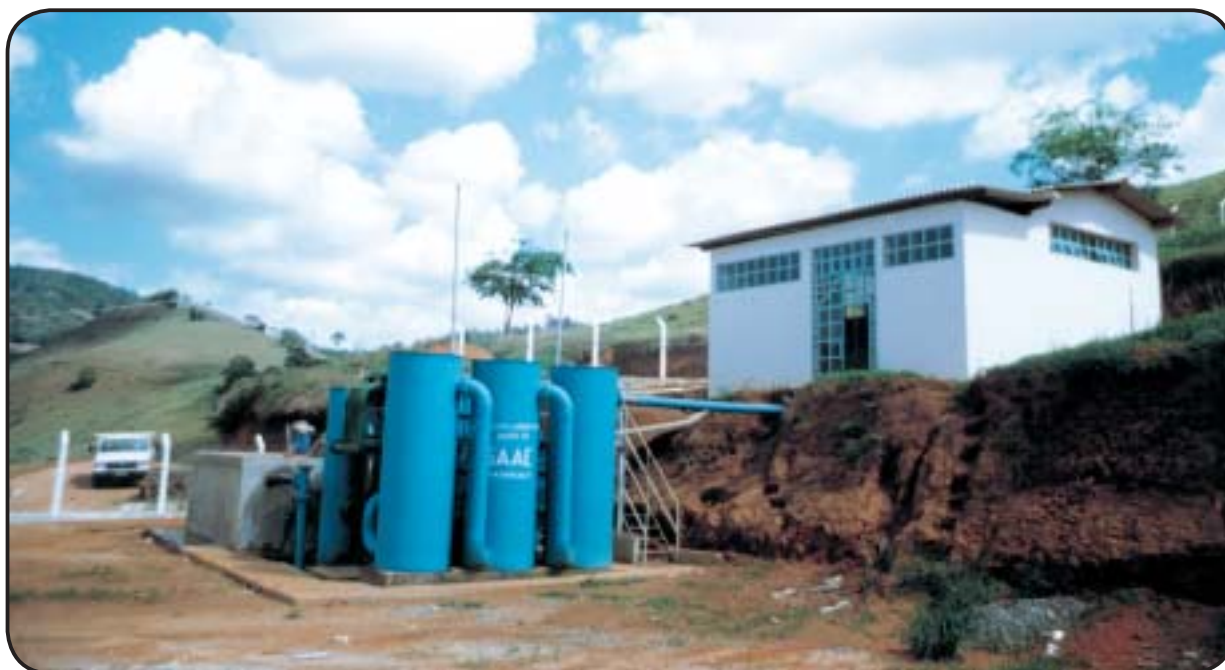
Foto 4 — ETA compacta com casa de química
