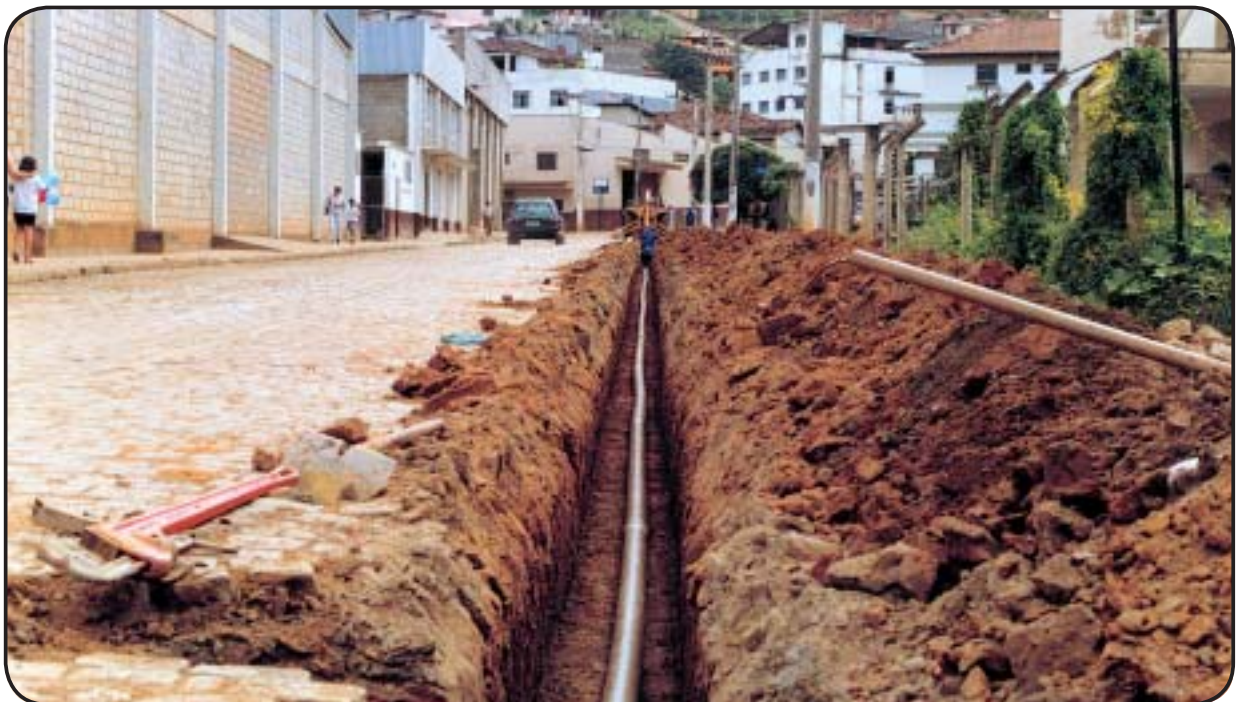
Foto 6 — Rede de distribuição em PVC PBA
