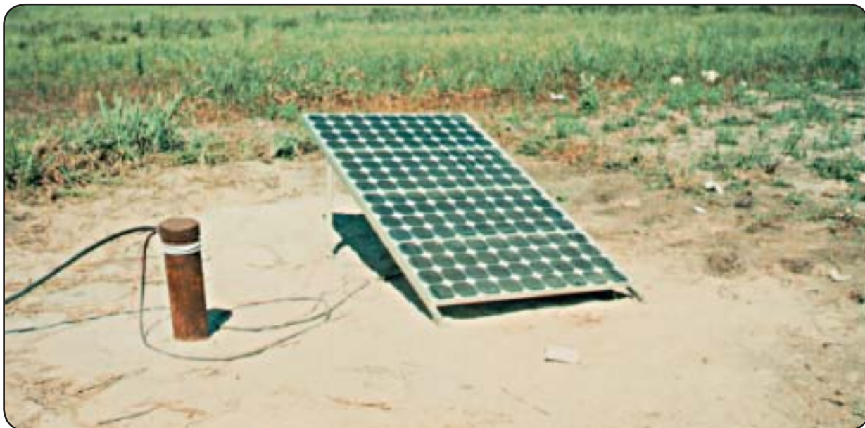
Foto 9 — Conjunto de módulos fotovoltaicos e bomba submersa instalados em poço tubular profundo.
