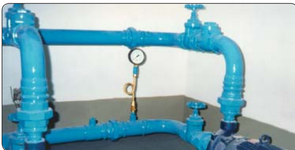
Foto 7 — Estação elevatória de água tratada
