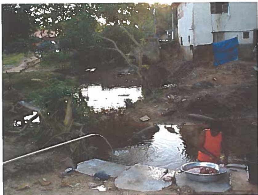
Figura 5.9. Lançamento irregular de esgoto diretamente na drenagem urbana.
