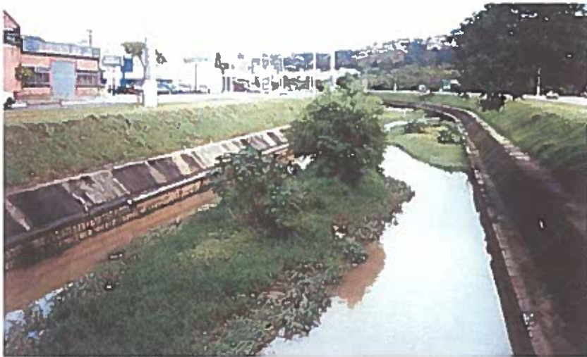
Figura 5.4. Assoreamento da macro-drenagem urbana.
