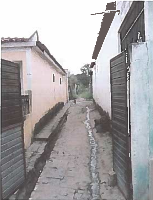
Figura 5.8. Lançamento irregular de esgoto diretamente na via pública.
