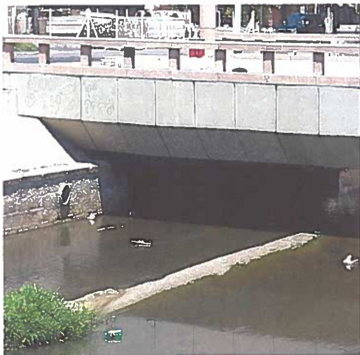
Figura 5.5. Obstrução ao escoamento por projetos mal concebidos.
