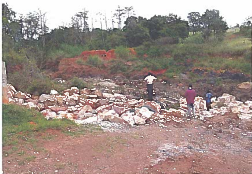
Figura 5.14. Destruição de obras de drenagem por erros de projeto.
