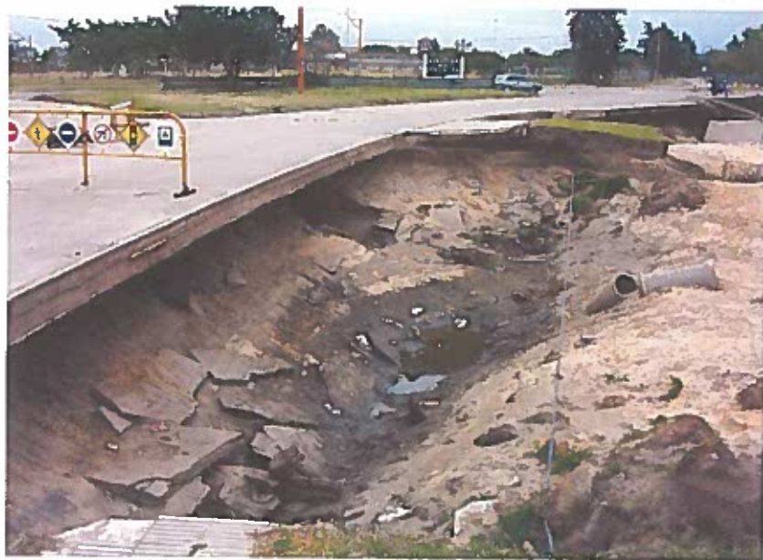
Figura 5.15. Destruição da infra-estrutura urbana devido à inundação.
