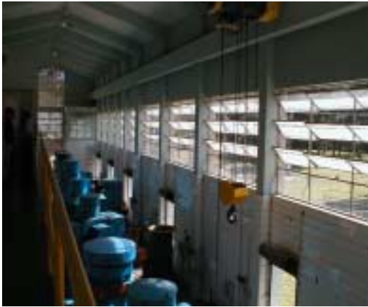
Fig. 3 - Sala de máquinas de elevatória
