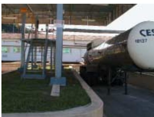
Fig. 12 - Sistema de armazenagem de cloro
