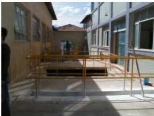
Fig. 7- Proteção instalada sobre tubulações de drenagem de produtos químicos
