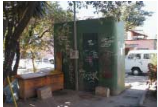
Fig. 27 – MPA instalado em praça pública dotado de água, luz e rede de esgoto. A caixa ao lado destina-se, exclusivamente, à guarda de ferramentas
