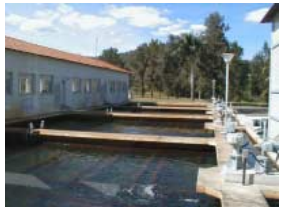
Fig. 6 - Tanque para tratamento e armazenagem de água
