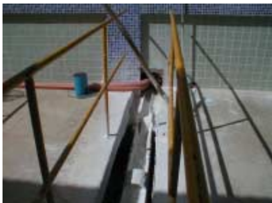
Fig. 8 - Proteção instalada sobre tubulações de drenagem de produtos químicos
