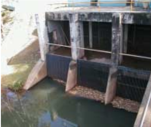
Fig. 1- Conjunto de grades do tratamento preliminar de água
