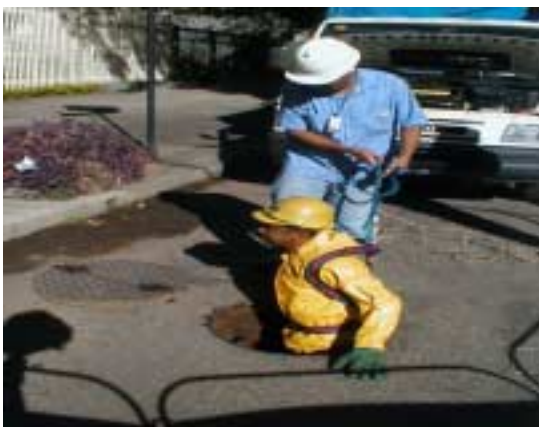
Fig. 17 - Descida de trabalhador preso a cinto de segurança fixado em veículo e corda segura por colega trabalho
