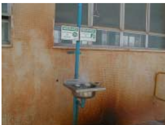
Fig. 11- Lava olhos no setor de produtos químicos acionado por dispositivo instalado no piso
