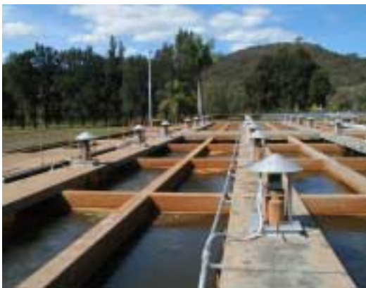
Fig. 5 - Tanque para tratamento e armazenagem de água
