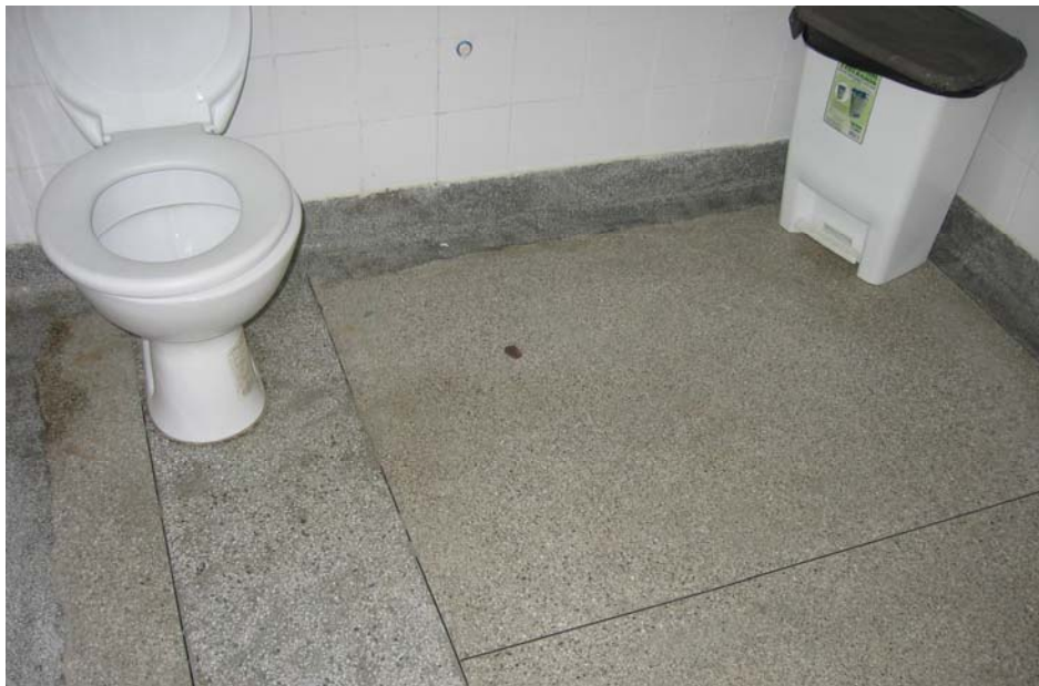
Foto 19. Sanitário atual. Fonte: A autora em 17 de outubro de 2007
