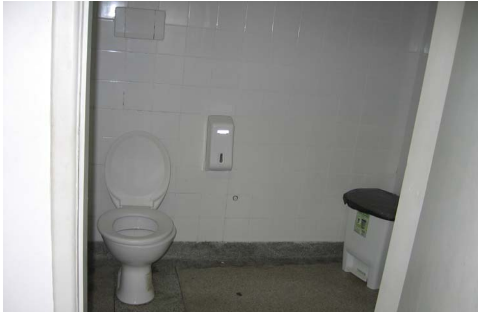
Foto 12. Sanitários com área de transferência suficiente. Fonte: A autora em 17 de outubro de 2007
