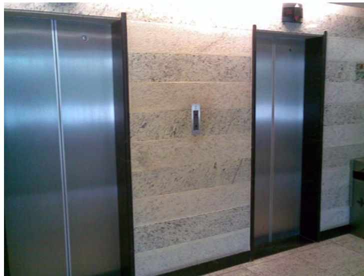
Foto 3: Vista externa de dois elevadores Fonte: Autora
