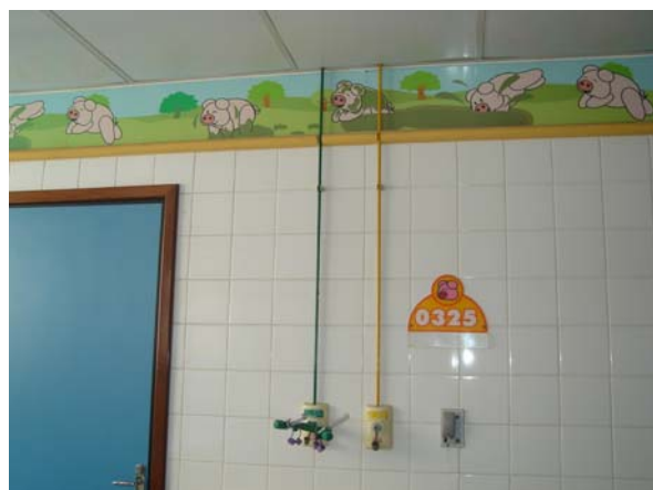
Figura 13: Tubulações aparentes no hospital filantrópico
