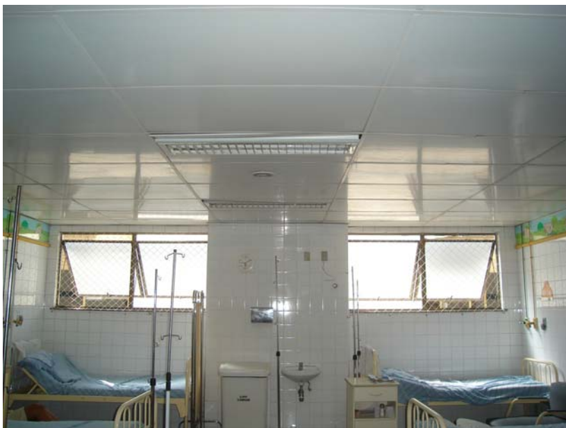
Figura 11: Vista da iluminação artificial centralizada na enfermaria
