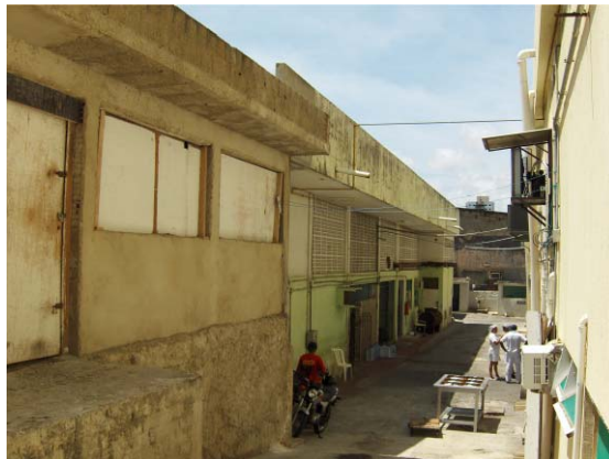
Figura 19: Ampliação do bloco C que abrigará as novas instalações do setor de nutrição e dietética. Fonte: Autora, 2008.
