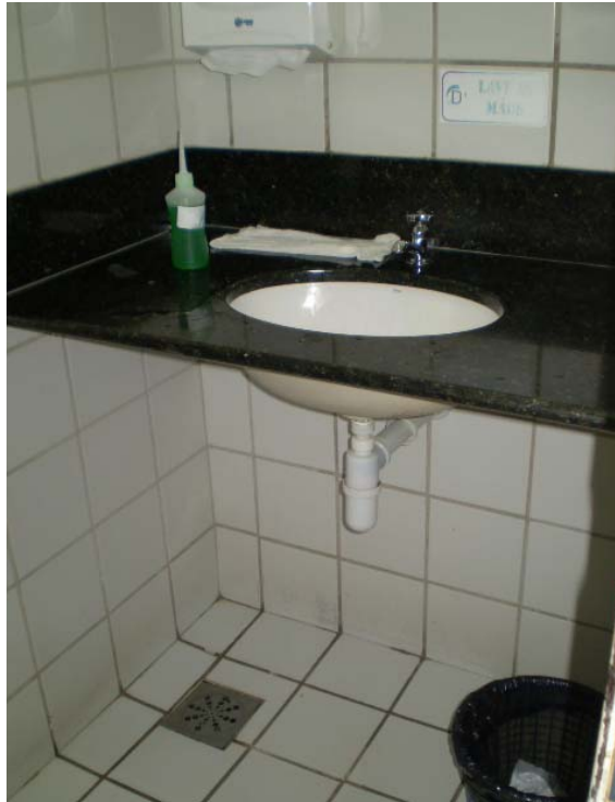
Foto 28 – Hospital 4 – Vestiário Lavagem Fonte: Autora, 2007.
