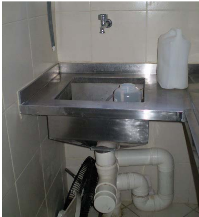
Fotos 23 – Hospital 3 – Sala de Utilidades – pia de despejo Fonte: Autora, 2007.
