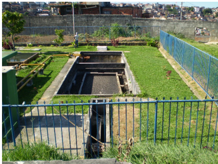
Foto 25 – Hospital 3 – ETE tanque de lodo seco para limpeza Fonte: Autora, 2007.
