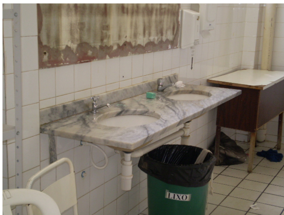
Foto 38 – Hospital 4 – Vestiário Funcionários - feminino Fonte: Autora, 2007.
