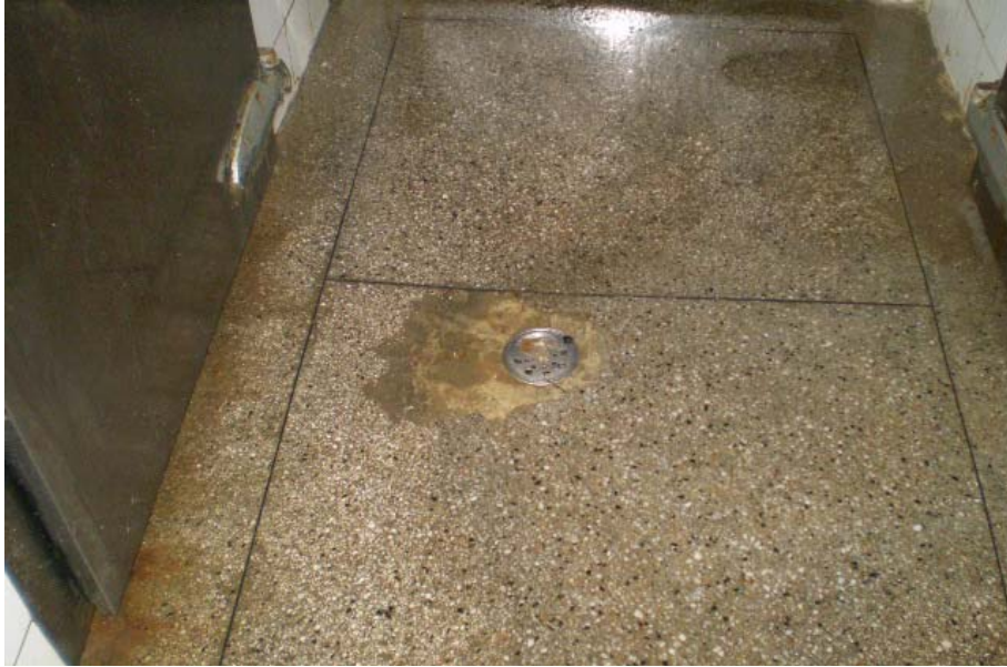
Foto 35 – Hospital 4 – Cozinha – ante-sala câmaras frias Fonte: Autora, 2007.
