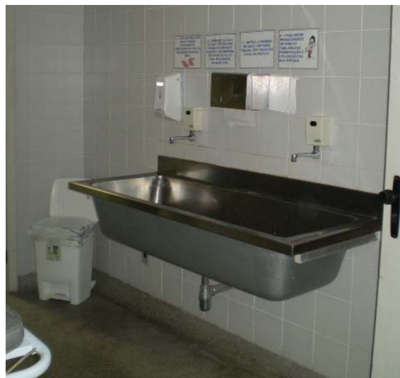
Foto 3 – Hospital 1- Lavabo cirúrgico no acesso sala de tratamento hemodiálise.. Fonte: A Autora, 2007.
