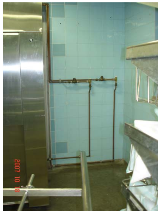
Foto 8 – Hospital 1 – CME instalações aparentes Fonte: Autora, 2007.
