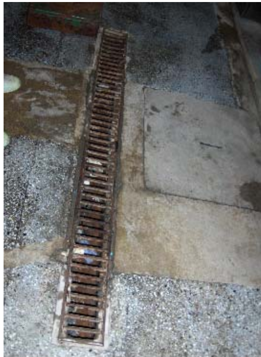
Foto 36 – Hospital 4 – Unidade de Processamento de roupas – Área suja – grelha Fonte: Autora, 2007.
