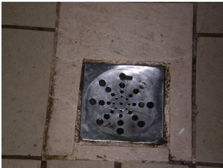
Foto 32 – Hospital 4 – Cozinha – ralo sem tampa Fonte: Autora, 2007.
