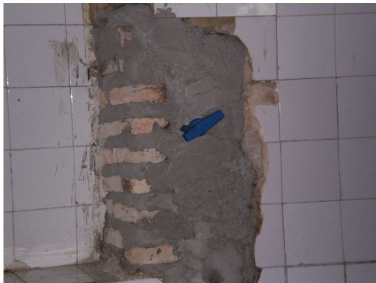
Foto 31 – Hospital 4 – Cozinha – registro improvisado Fonte: Autora, 2007.
