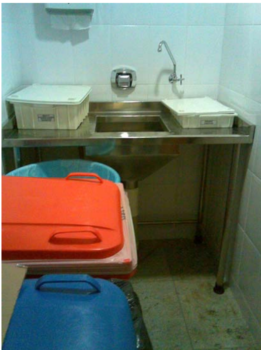
Fotos 16 – Hospital 2 – Sala de Expurgo Fonte: Autora, 2007.
