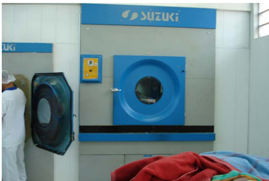
FIGURA 18 – Secadora isolada por divisória
