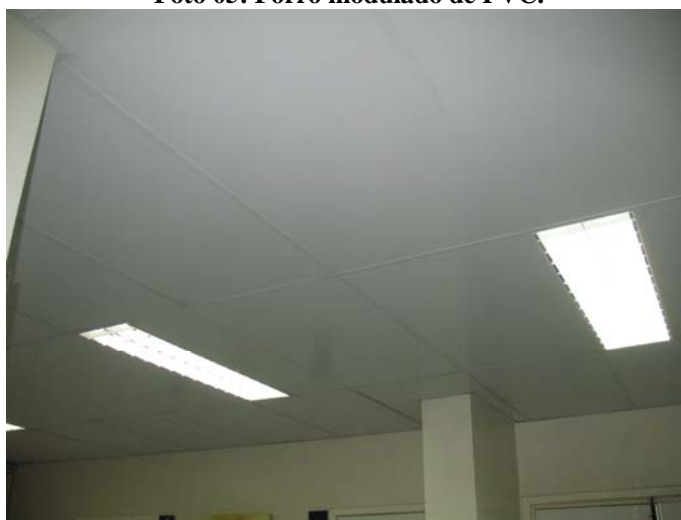
Foto 05: Forro modulado de PVC.
