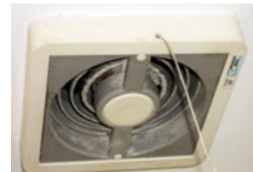
Figura 81. Exaustor da câmara escura precisando de limpeza Fonte: Acervo SQRI.
