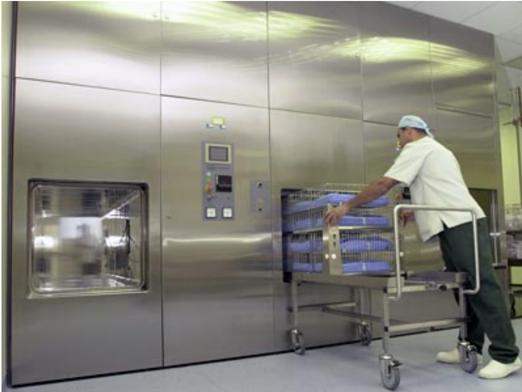
Figura 22– Autoclave de Barreira
