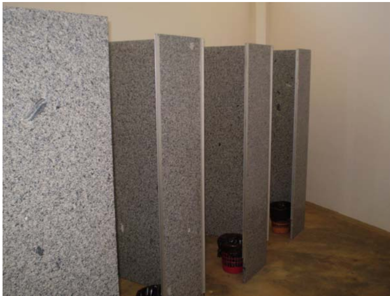
Foto 03: Banheiro não adaptado às necessidades dos usuários
