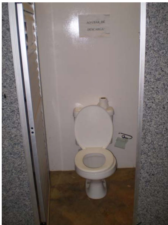
Foto 04. Banheiro não adaptado às necessidades dos usuários
