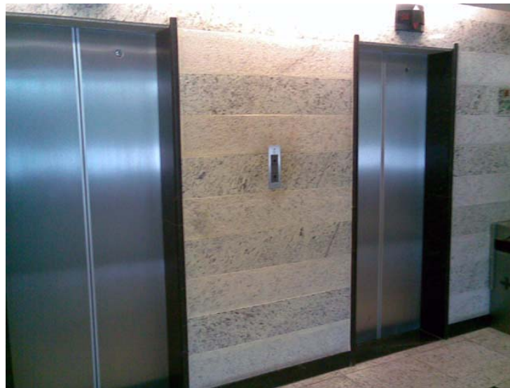
Foto 3: Vista externa de dois elevadores Fonte: Autora
