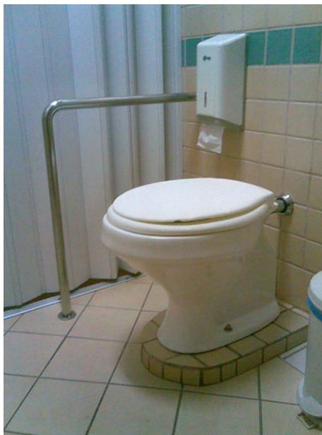
Foto 5: Detalhes de Vaso Sanitário Fonte: Autora
