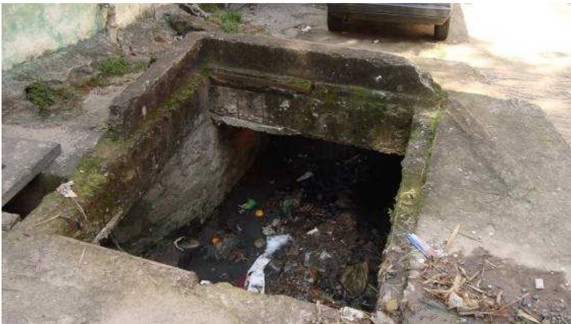
Foto 14. Esgoto a céu aberto. 2009. Fonte: Trabalho de Campo.
